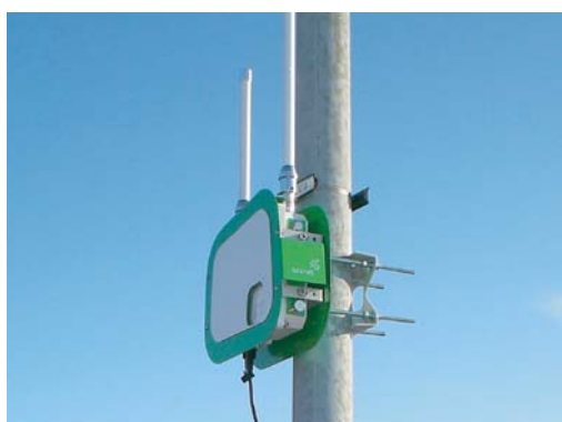
Einrichtung eines Monitoring-Systems in Verbindung mit einem WLAN-Netzwerk, Schleuse Brunsbüttel
